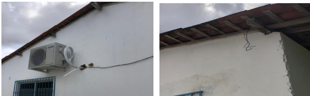
Imagens de tubulação e fiações expostas.
