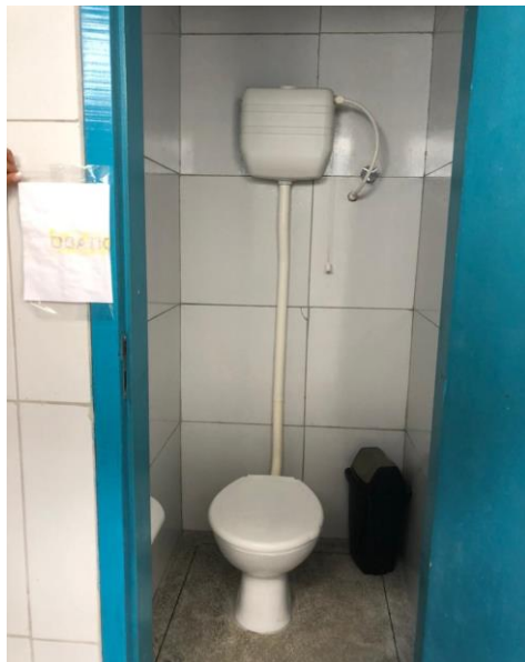
Imagem da bacia sanitária demandando reparos.
