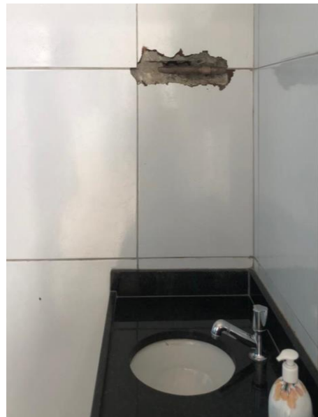
Imagem de quebra de revestimento de parede.
